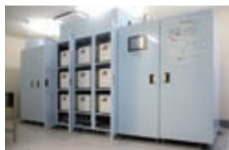
多床用電解水透析システム導入例
